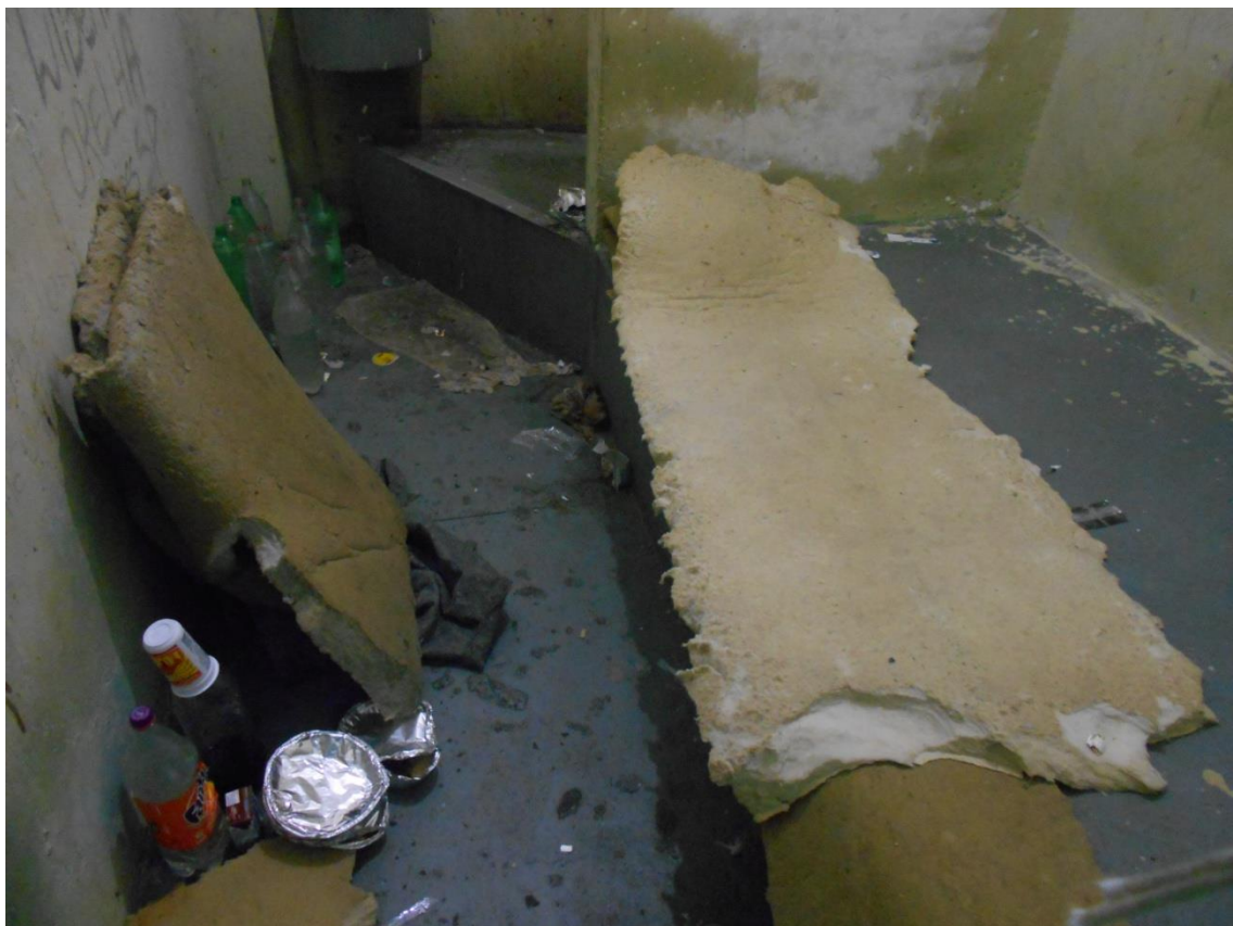
Estado lastimável de uma cela de Isolamento do Presídio João Carlos da Silva.
