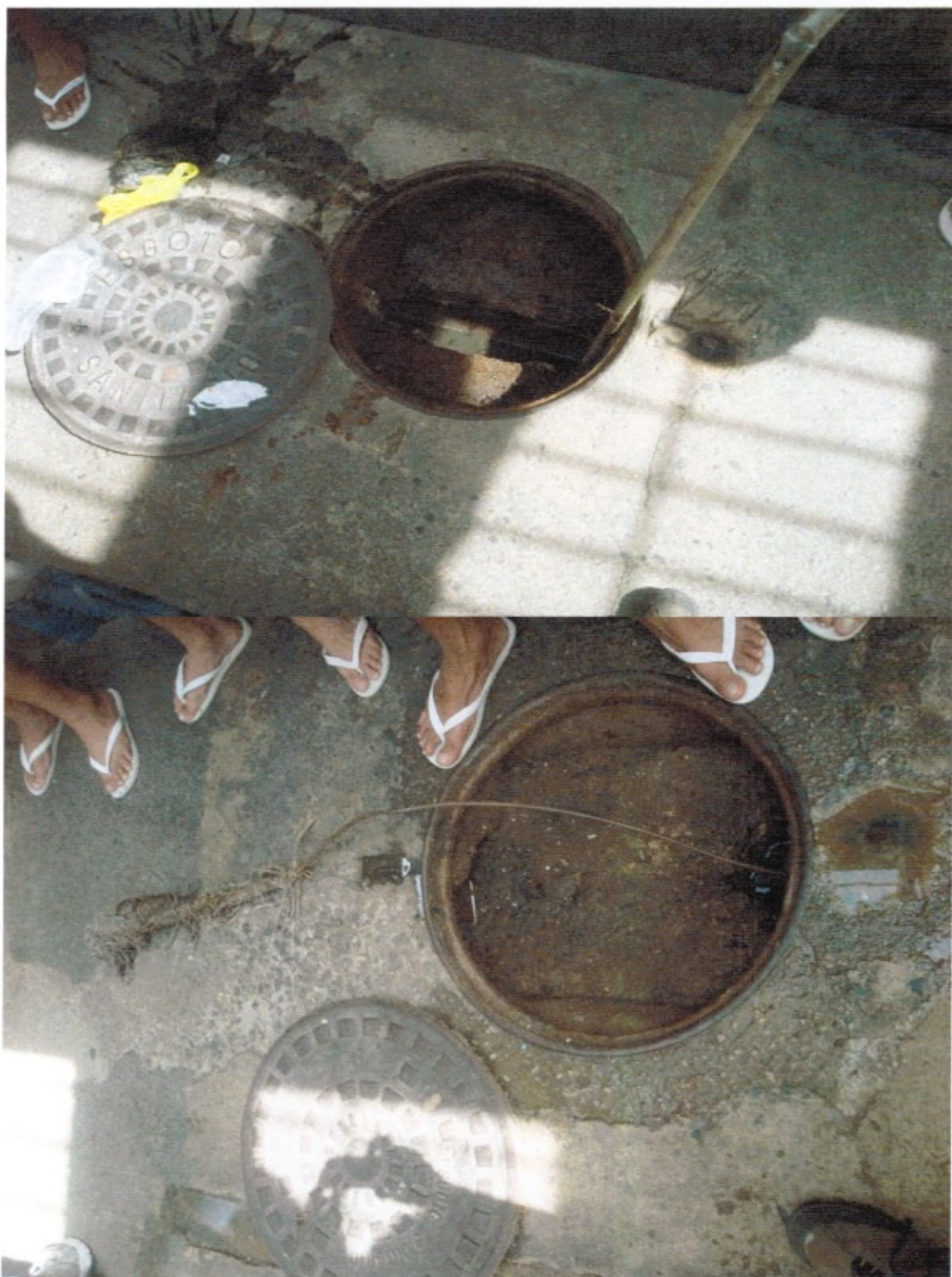
Imagens 13 e 14: encanamento de esgoto comprometido nas galerias 9 e 12 causando mau cheiro e contribuindo para o ambiente já insalubre.
