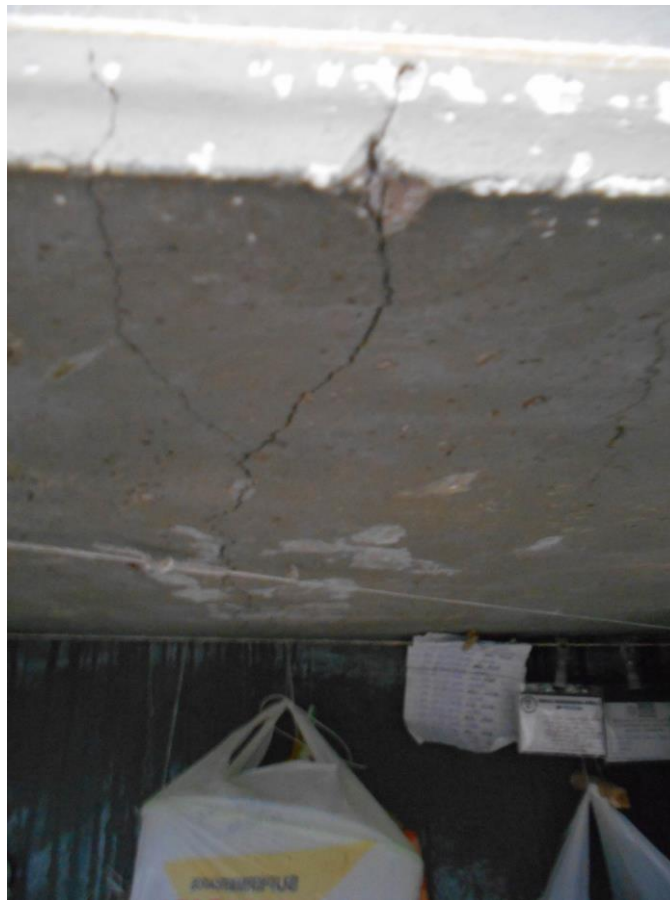
Rachaduras encontradas na comarca.
