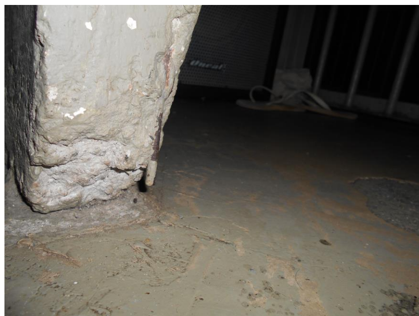
Viga aparecendo na cela, estado de deterioração na Unidade.
