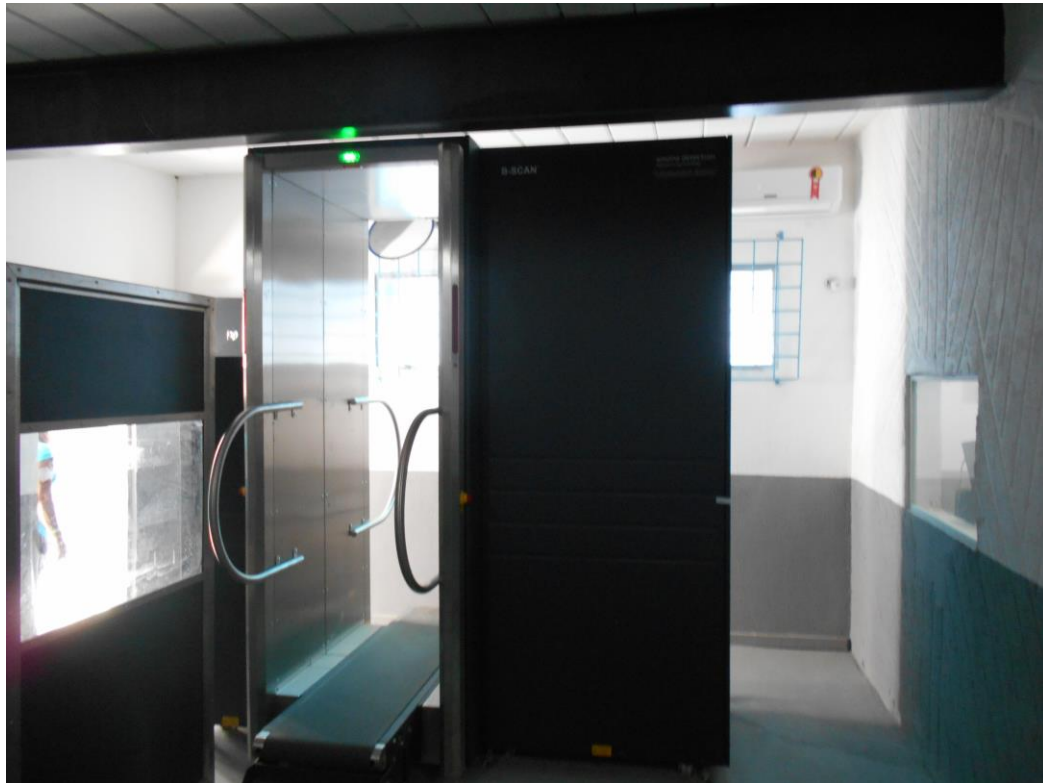
Escâner em funcionamento na entrada da unidade.
