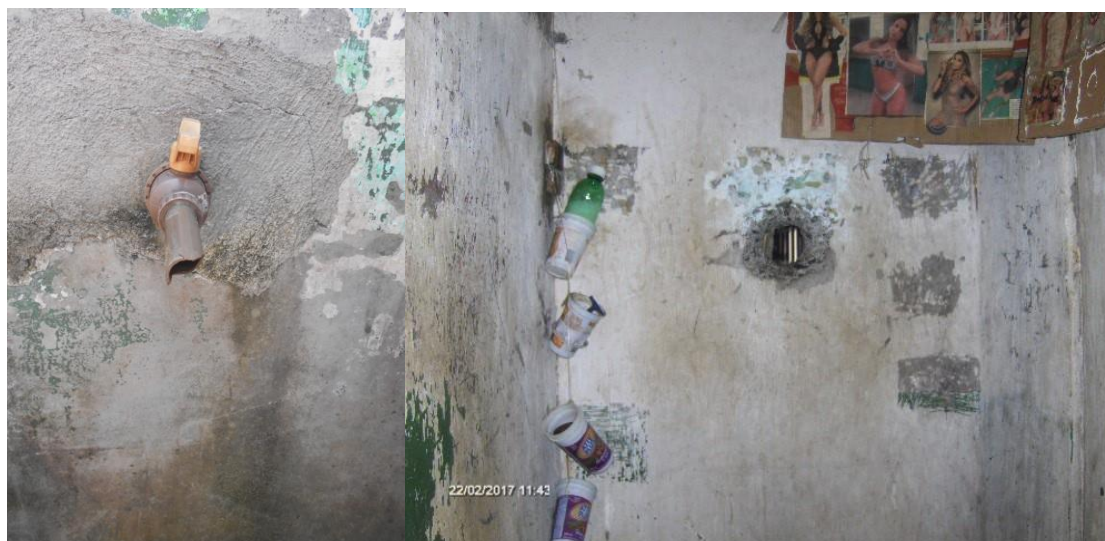
Um dos canos e uma parede quebrados em uma das galerias da Unidade.
