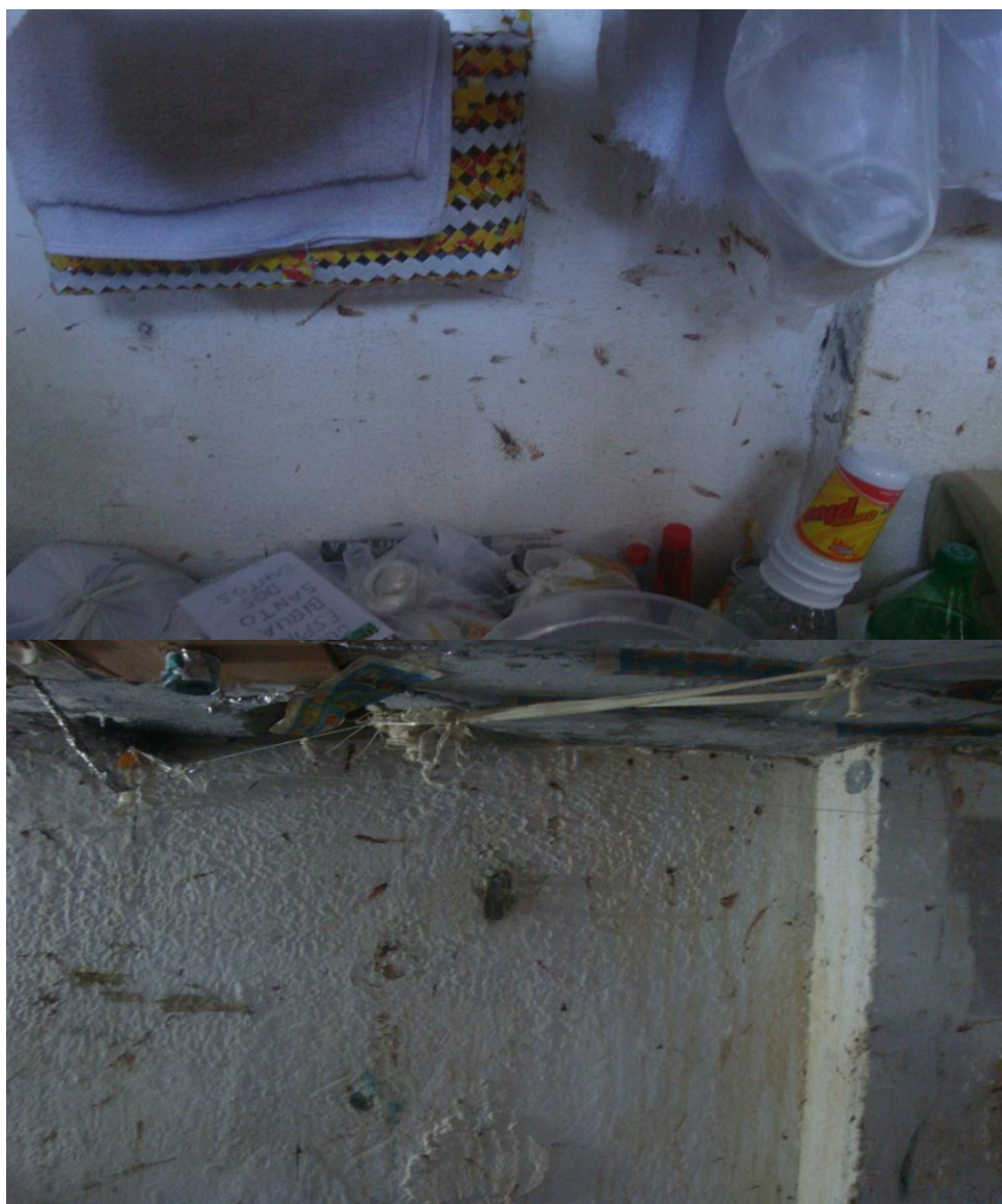
Imagens 2 e 3 – Manchas de sangue nas paredes, causadas por percevejos-de-cama.
