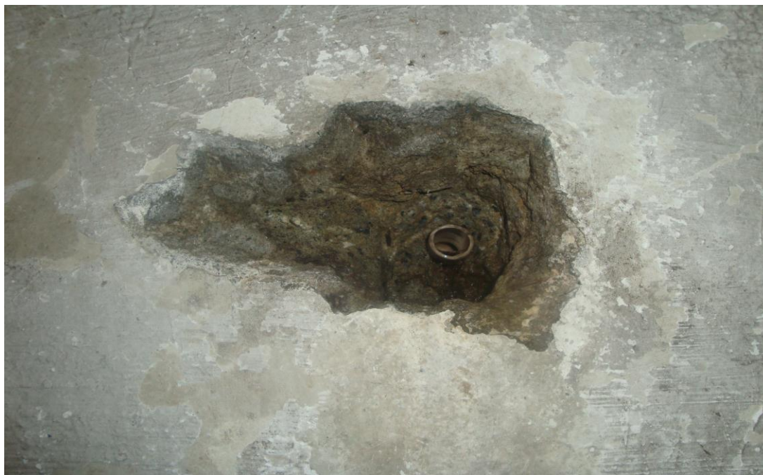
Imagem 52 – buraco na parede do banheiro de uma cela, por onde é fornecida a água aos detentos.
