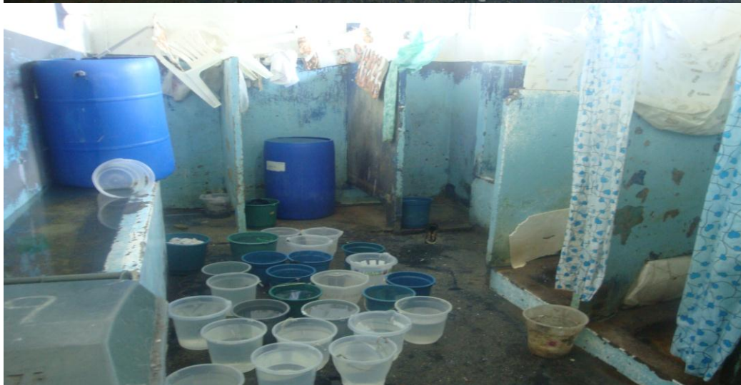
Imagens 55 e 56 – Baldes com água armazenados nos banheiros da cela.
