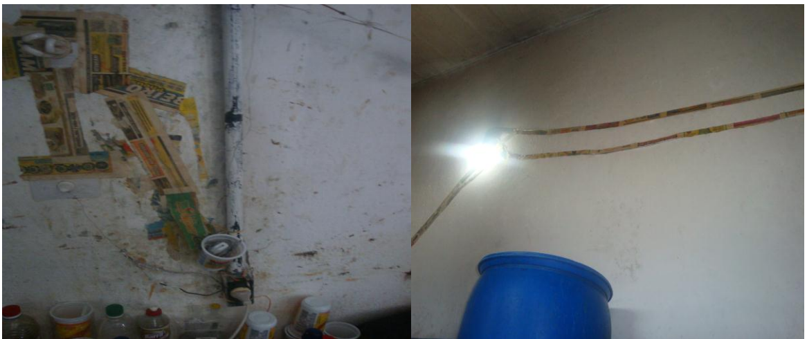
Imagens 28 e 29 – Improvisos de instalações elétricas nas celas
