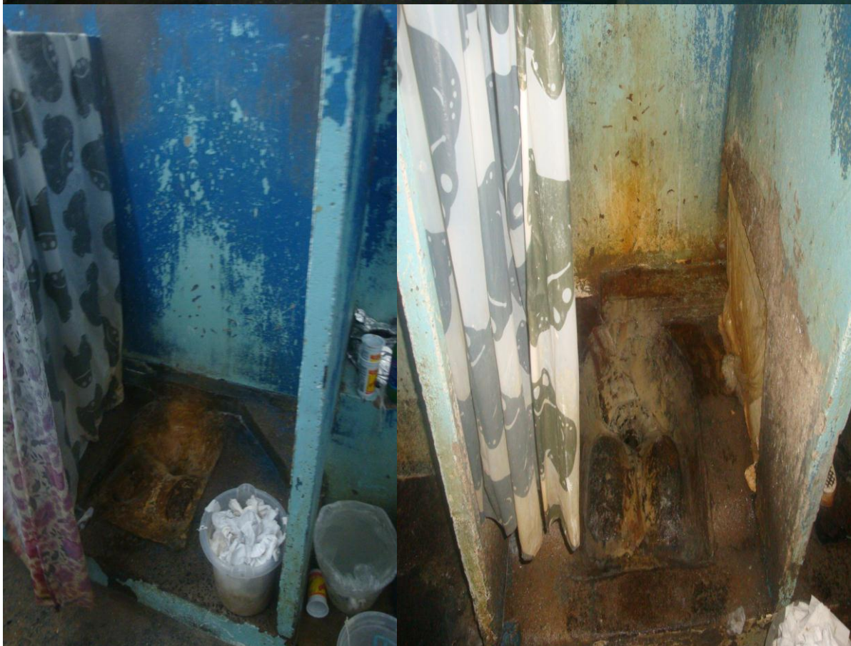
Imagens 25 e 26– Estado em que se encontram os banheiros das celas
