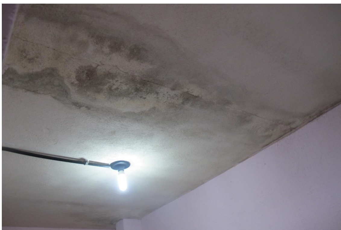
Infiltração no teto de uma das celas utilizadas pelas internas que trabalham na padaria.
