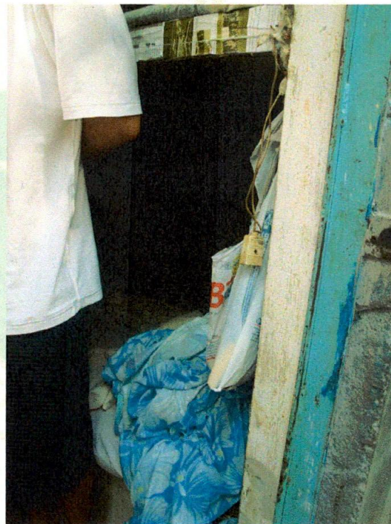
Instalação elétrica precária na cela.
