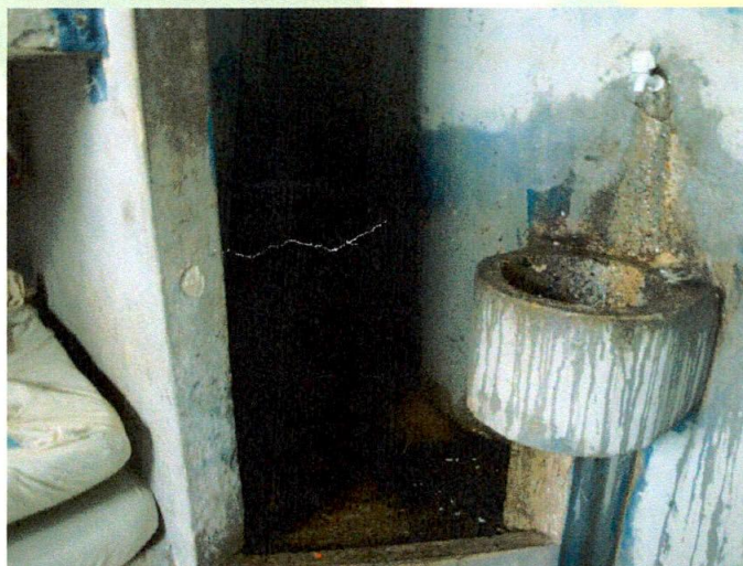
Situação precária dos banheiros nas celas.
