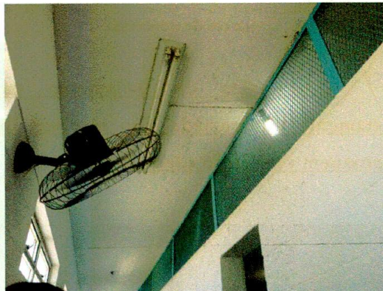
Ventilador num corredor.
