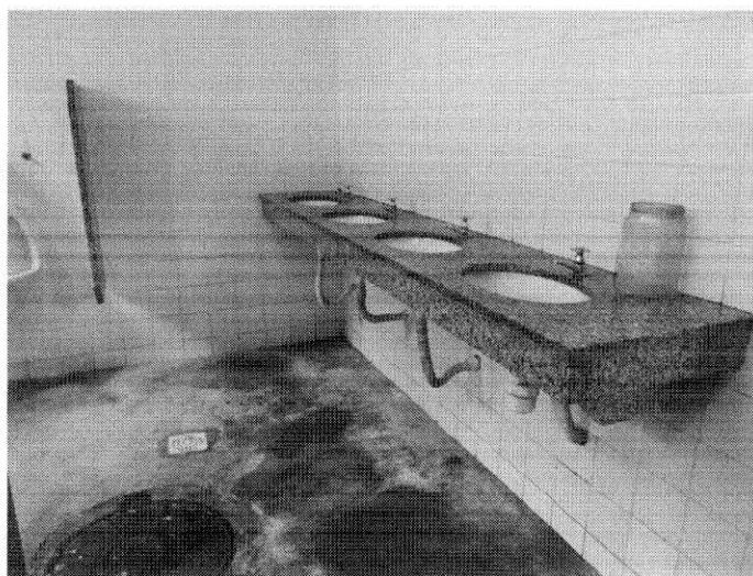
Foto 42. Estado do chão do banheiro masculino do Pátio de Visitas
