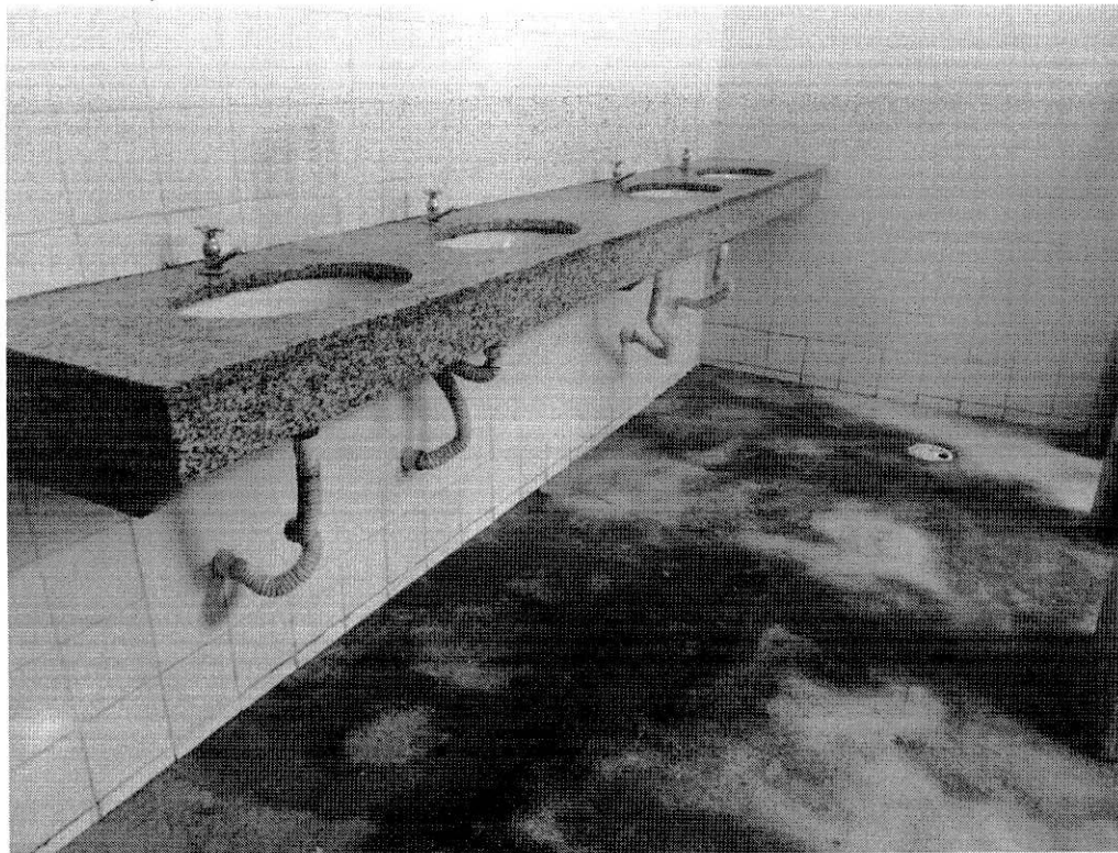
Foto 43. Estado do chão do banheiro feminino do Pátio de Visitas
