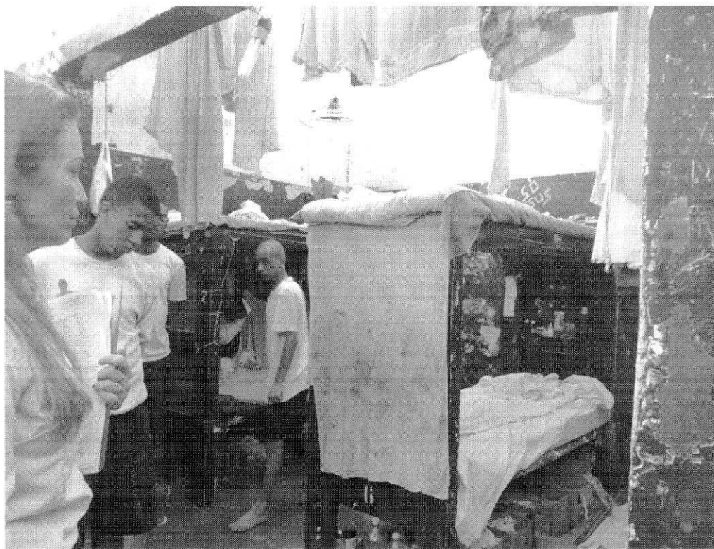
Foto 28. Sujeira e falta de manutenção do local onde dormem os internos
