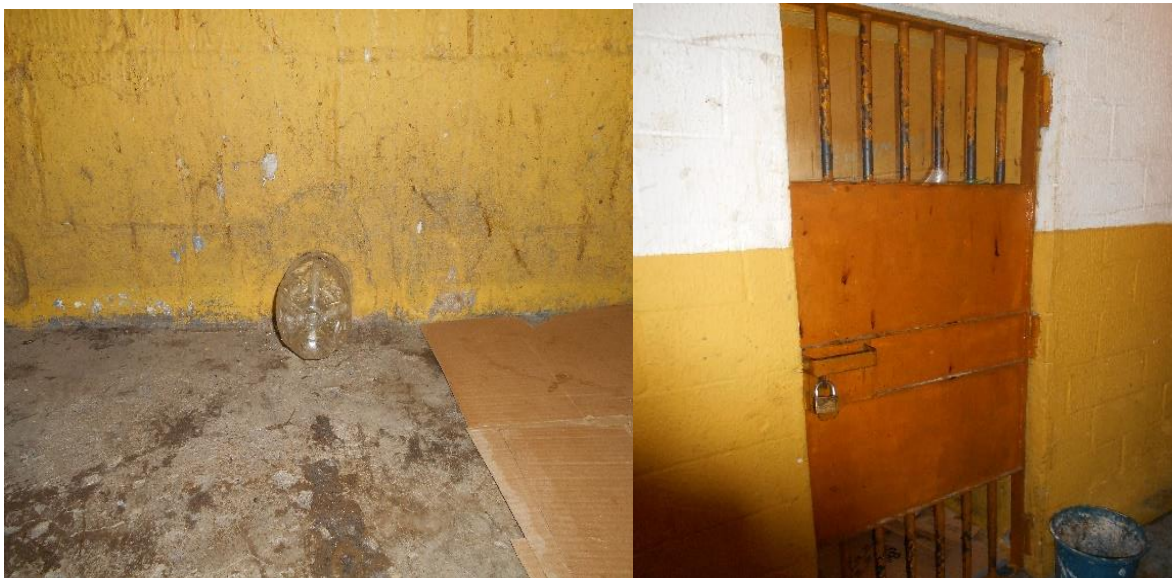
Buraco no corredor, por onde ratos circulavam e a porta com chapa de aço do setor.
