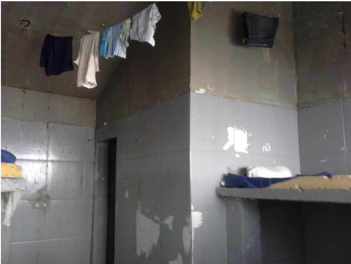
Foto 6. O varal acima é preso nos bocais onde deveria haver luz artificial.
