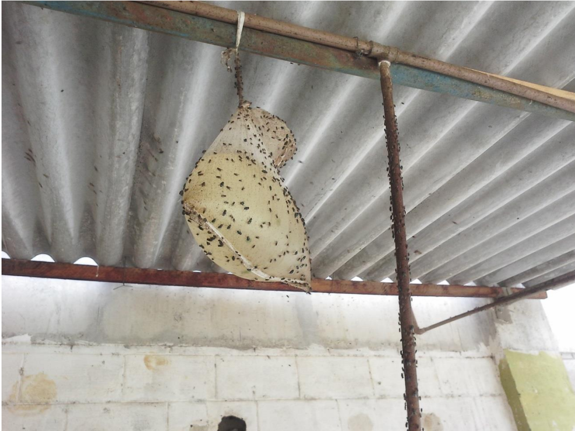
Foto 36. Esta é a condição de trabalho no lixão. Na imagem, mais de 350 (trezentos e cinquenta) moscas de diversos tamanhos e tipos.
