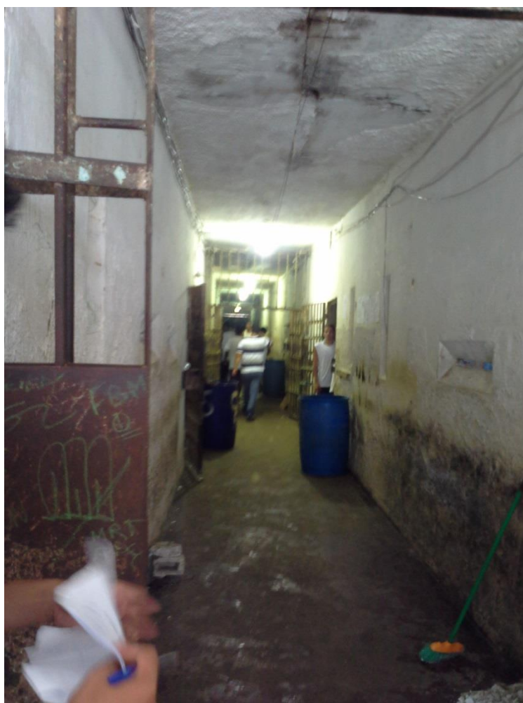
Foto 17. Galeria de um pavilhão, com quatro celas dispostas de cada lado. Aspecto deplorável de conservação, sujeira, lixo, diversas infiltrações e portas de celas completamente enferrujadas.
