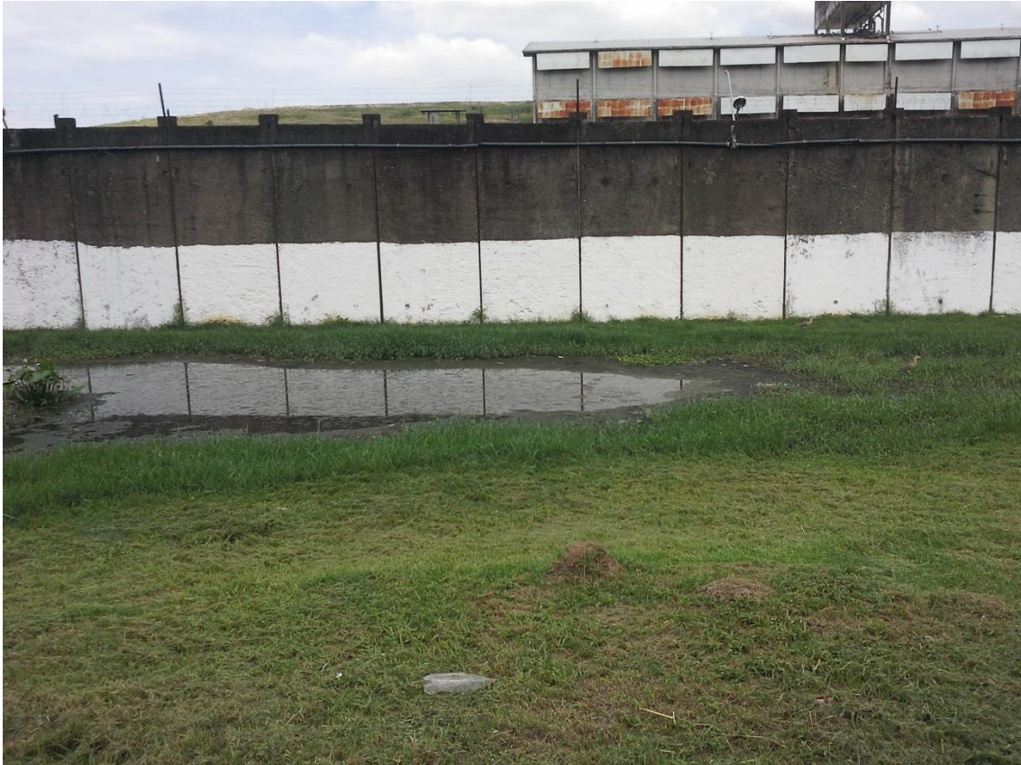
Foto 32. Durante nossa inspeção capturamos diversas imagens dos mais diversos exemplos de dano ambiental, todos demonstrando diversos focos de irrigação por parte do esgoto que caminha livre pelas valas. Depois de um pavilhão, avistamos esta imagem: a formação de um lago formado por esgoto. Literalmente o presídio é formado por um pântano.
