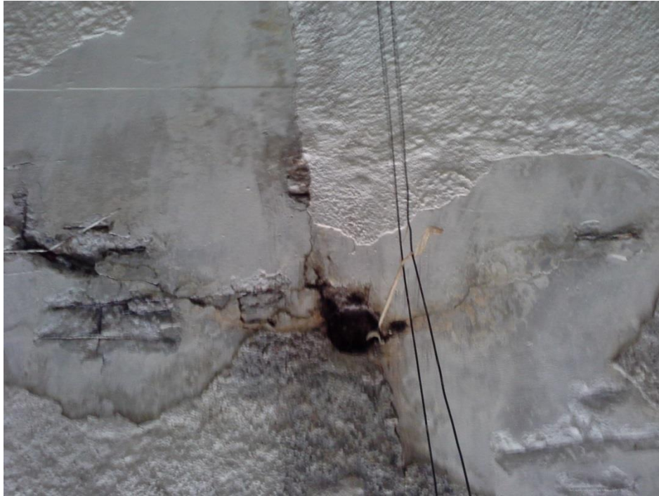
Foto 18. Teto da galeria completamente infiltrado, com partes já quebradas e sem qualquer concreto, com os vergalhões que estruturam o teto aparecendo em meio às rachaduras. No detalhe, o bocal sem lâmpada enferrujado pela infiltração e com a fiação para o lado de fora.
