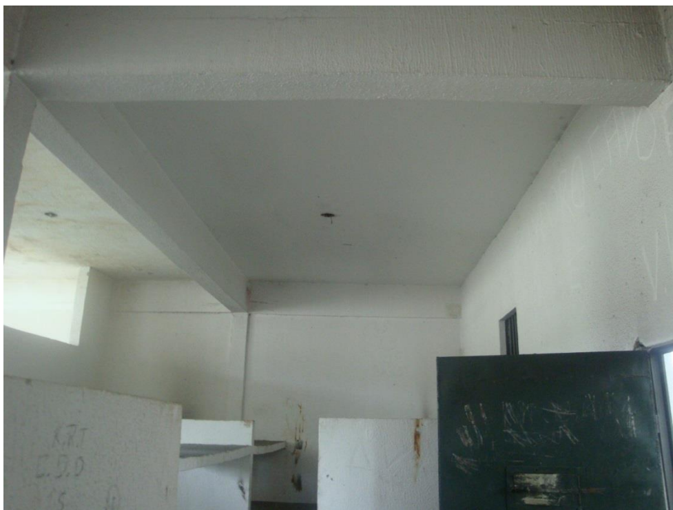
Foto 11. Aspecto da cela, suas comarcas sem colchão, dois bocais sem lâmpada, a porta de cela do tipo chapa de ferro, com apenas um visor apenas aberto pelo lado de fora e, no detalhe, uma das janelas frontais obstruídas.
