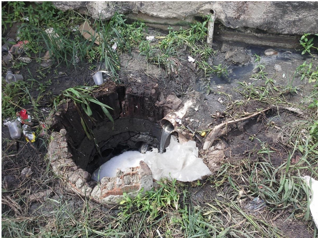
Foto 29. Mais uma imagem de esgoto a céu aberto, com a saída dos encanamentos da unidade, com o entorno completamente movediço e irrigado pelo esgoto.
