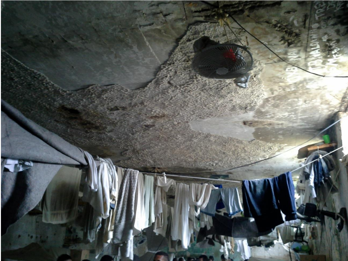
Foto 20. Varal de roupas e toalhas, ventiladores fixados e energizados por meio de gambiarras com materiais não apropriados, desgaste completo e infiltração do teto da unidade. A imagem ainda aponta para provável desabamento do teto em meio a uma cela superlotada.
