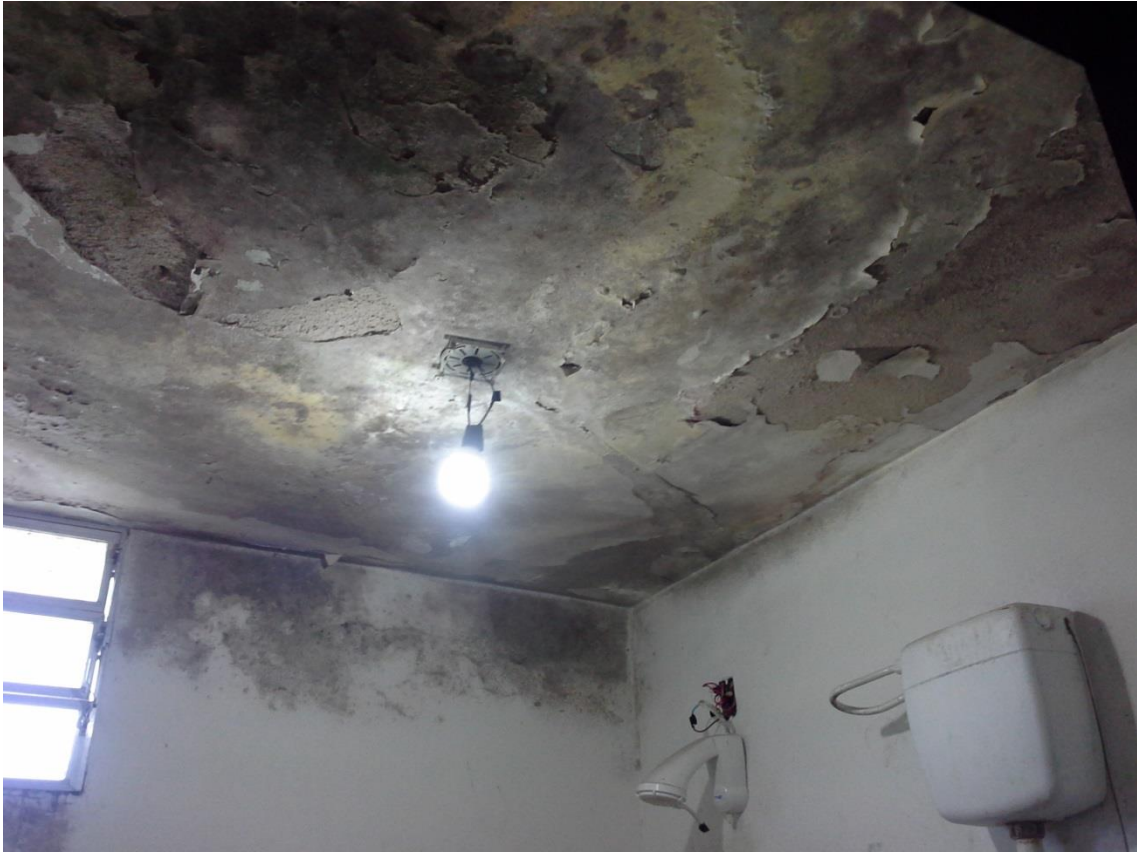
Foto 40. Péssimas condições de mofo, infiltração e total desgaste do teto do alojamento dos agentes.
