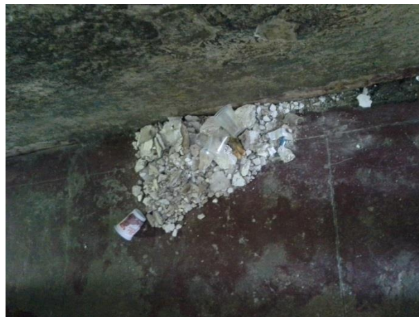
Foto 24. Entulho que caíra do teto na galeria - um pequeno exemplo que demonstra o risco iminente de desabamento dos tetos e paredes dos pavilhões.
