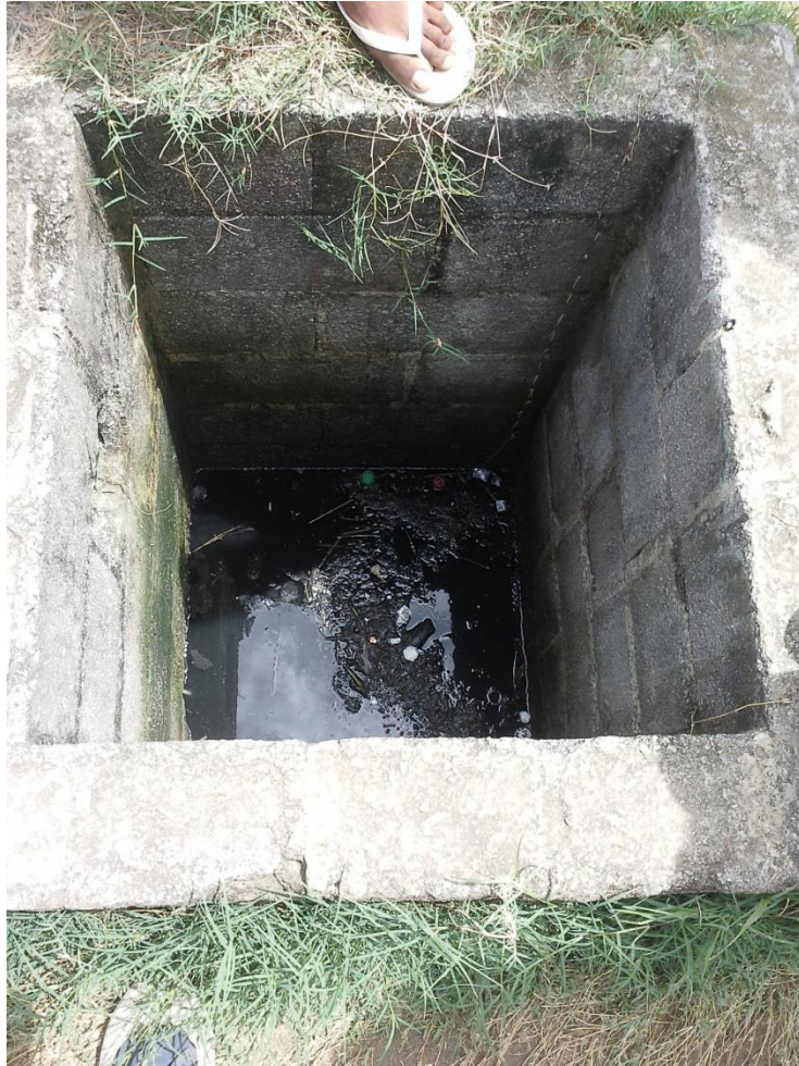
Foto 30. Mais um exemplo de esgoto a céu aberto.
