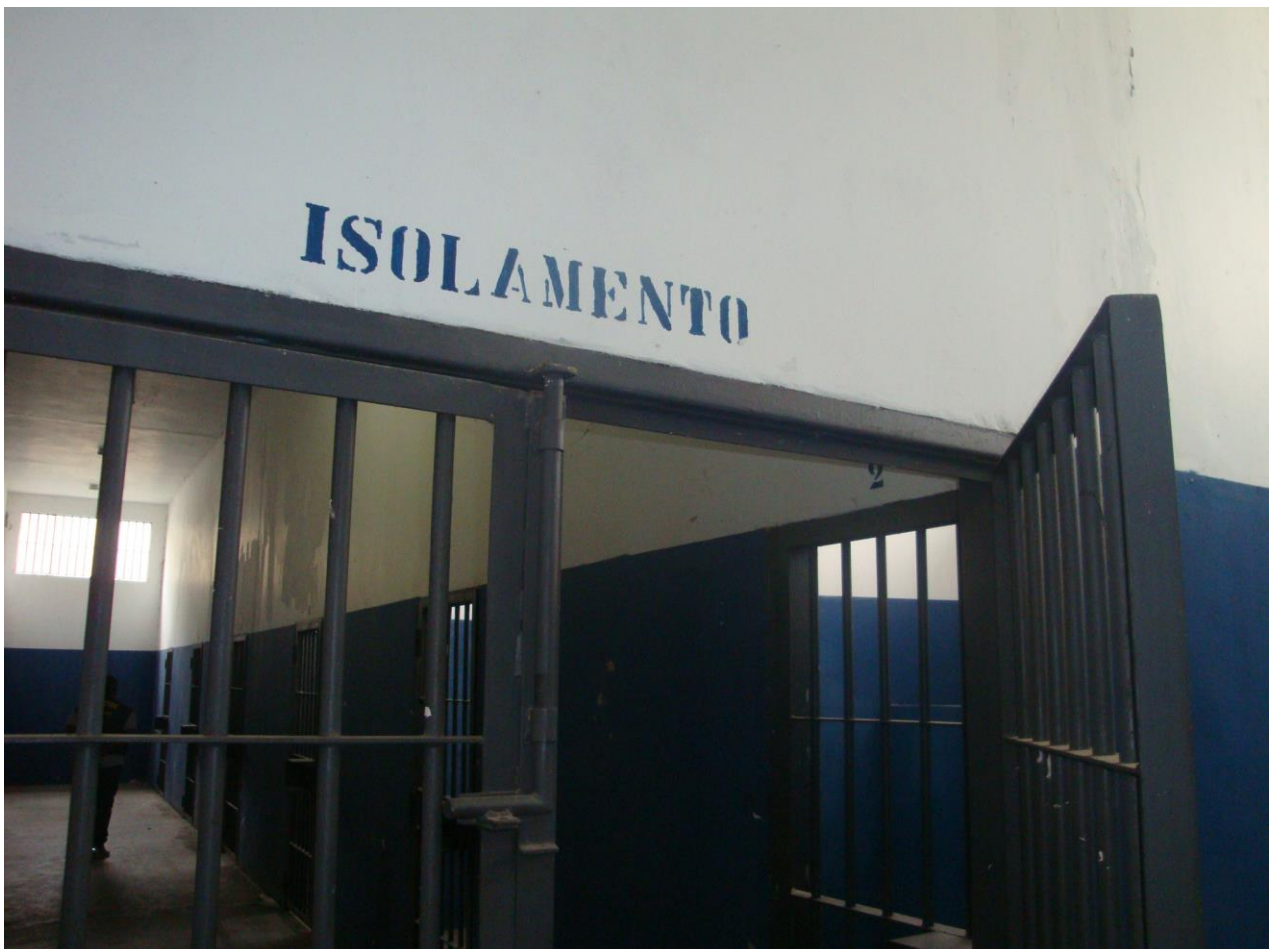
Foto 23. Galeria do isolamento. Contraste da luz solar com a iluminação do corredor ao fundo da foto já denota a deficiência de luz observada no local.
