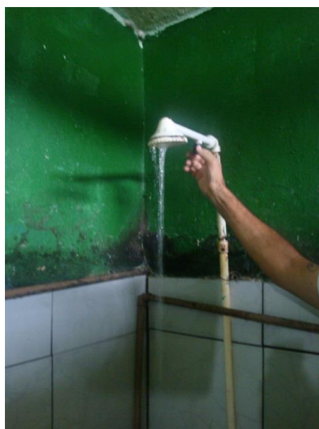
Foto 11. Detentos demonstrando o quão precária é a distribuição de água na unidade.
