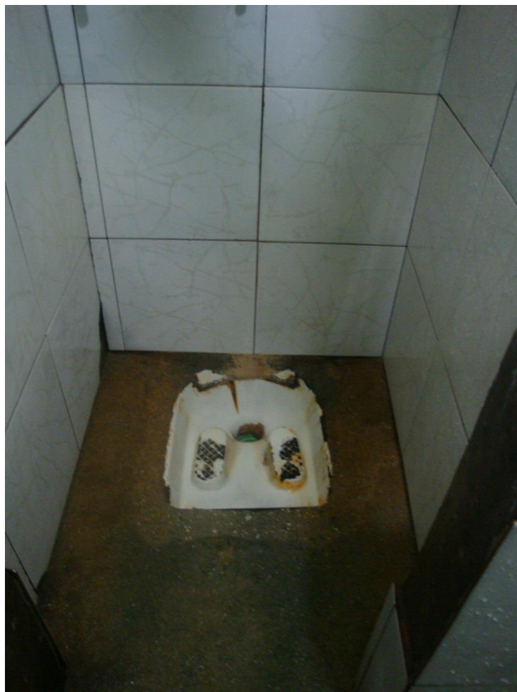
Foto 10. Este é um boi ; neste aparelho, os detentos fazem suas necessidades fisiológicas, entretanto, além do aparelho estar enferrujado e quebradiço, os detentos afirmam que este é mais um dos locais de acesso para pequenos bichos e diversos insetos.
