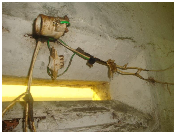
Foto 14. Gambiarras presentes nas celas para dar vazão à energia consumida. Altíssimo risco de curto circuito, agravado pela ausência de um programa de combate ao incêndio, pode levar a um incêndio generalizado nas celas.
