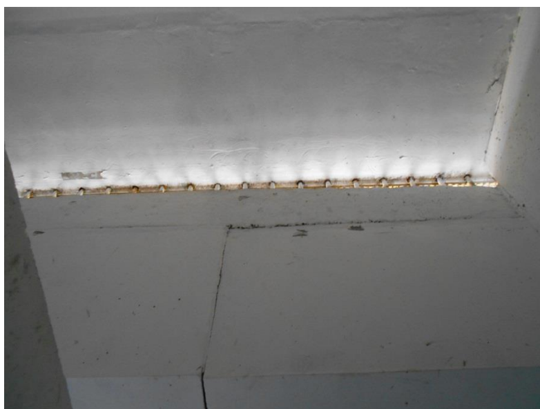
Vão estreito no teto dos cubículos, única fonte de circulação de ar e luz natural.
