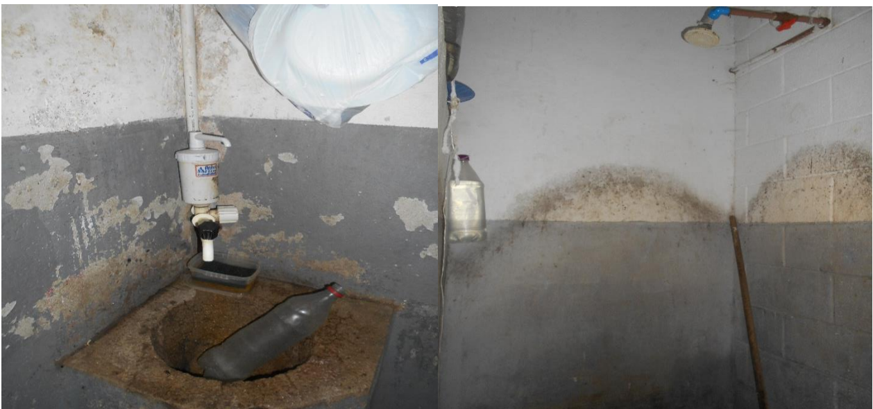
Instalações hidráulicas de uma das celas.
