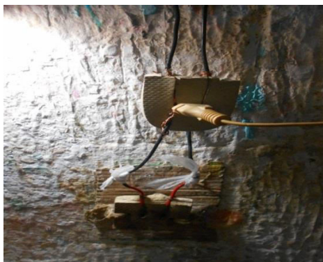
“Instalações elétricas” das celas coletivas.
