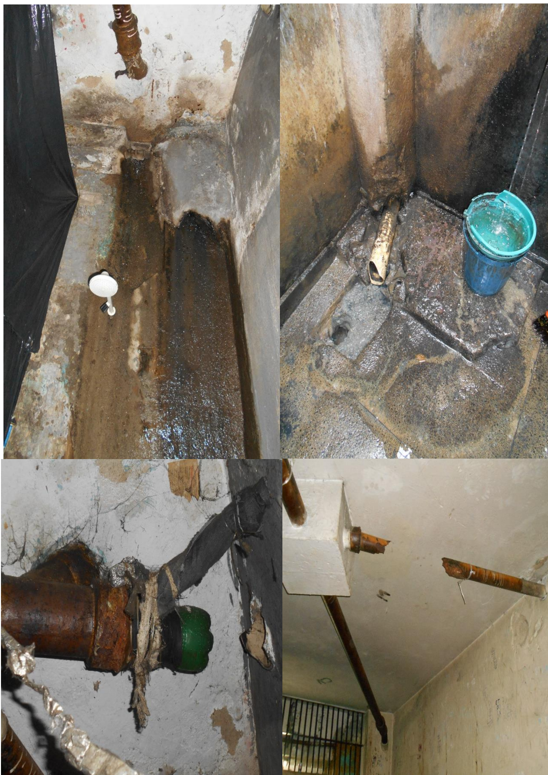
Infiltrações, canos quebrados e ralos entupidos são vistos em todas as celas da unidade.
