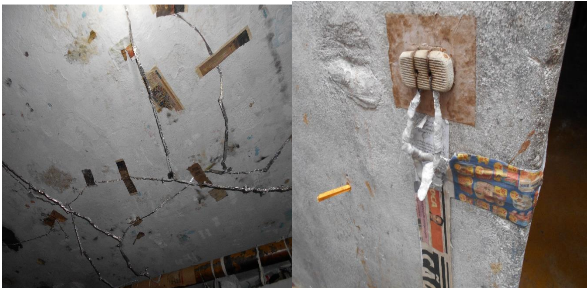
Gambiarras e improvisos na rede elétrica notados nas celas.
