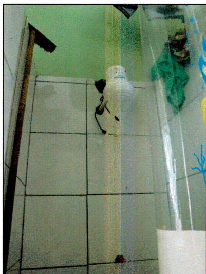
Chuveiro elétrico numa cela.
