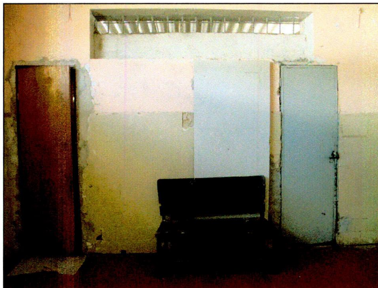
Entrada dos banheiros: apenas o da esquerda está em funcionamento.
