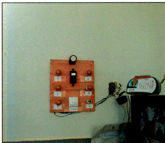
Painel de controle das celas.
