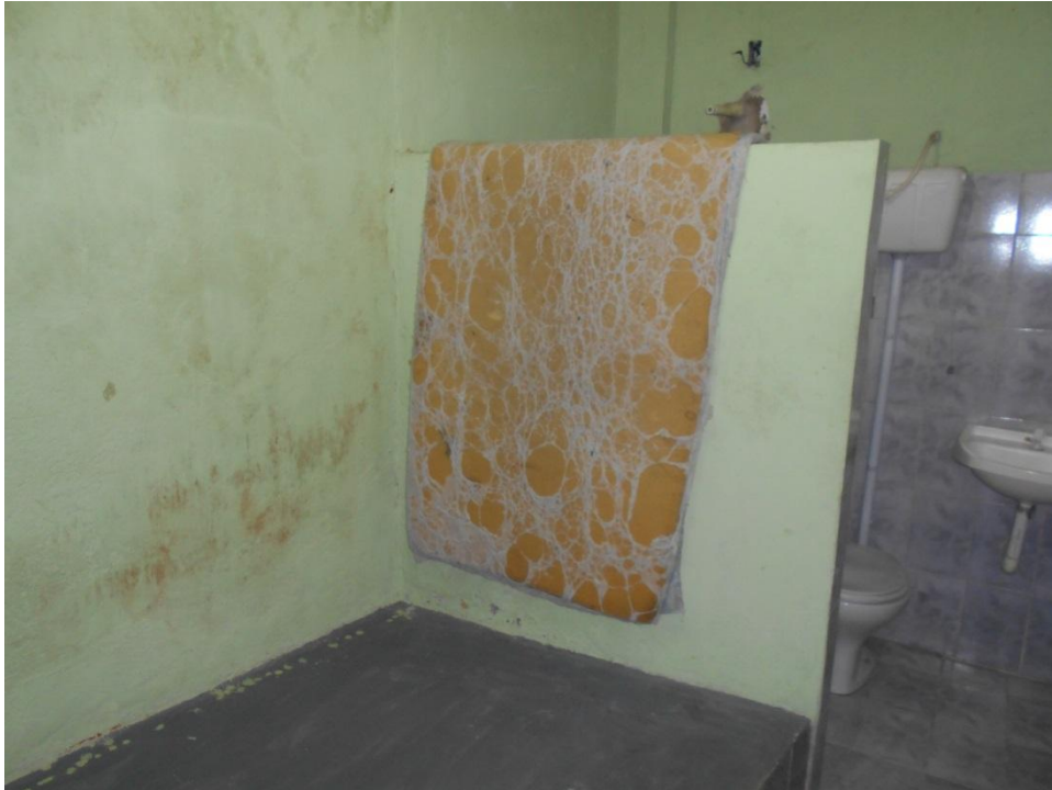
Foto 11. Parede suja, um fiapo de colchão e a comarca de cimento.
