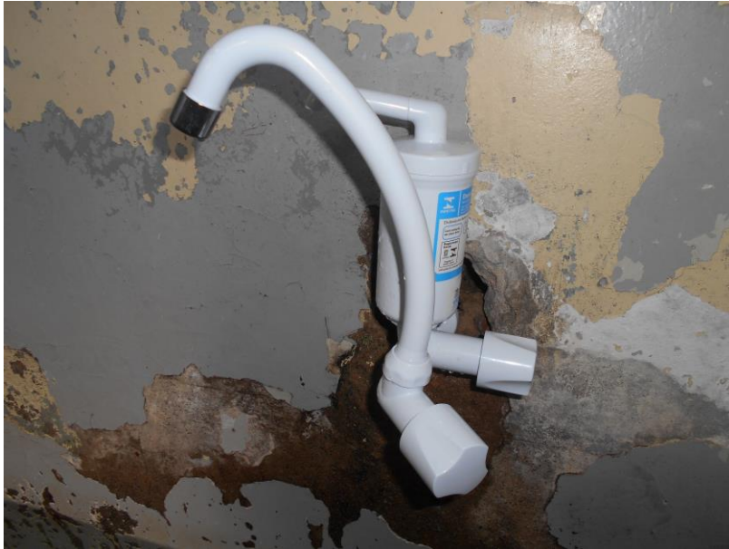
Uma das torneiras existentes nos banheiros da Unidade.
