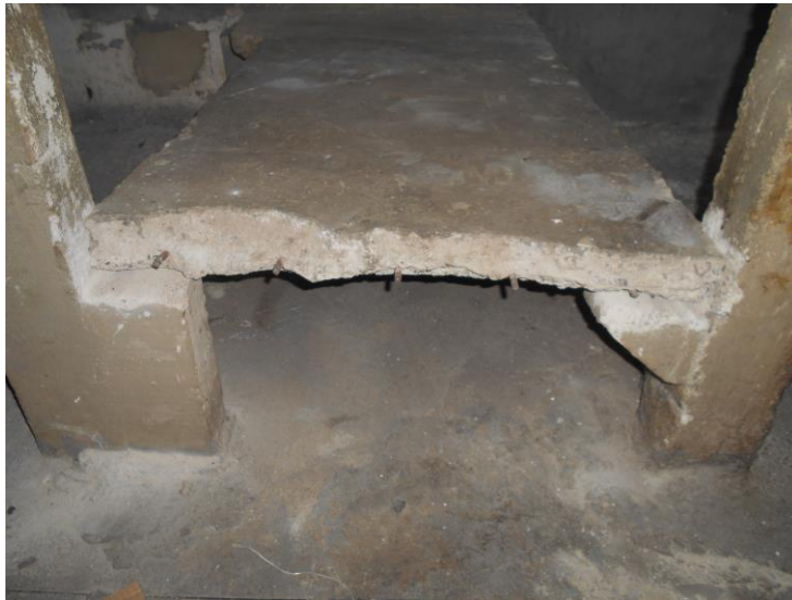
Foto demonstrativa do péssimo estado de conservação das comarcas da Unidade.
