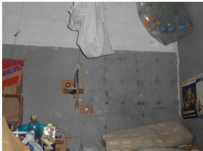
Instalações elétricas das celas coletivas.
