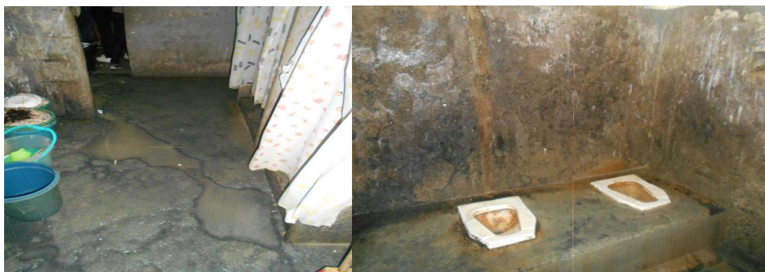
A situação deplorável dos banheiros das celas coletivas.
