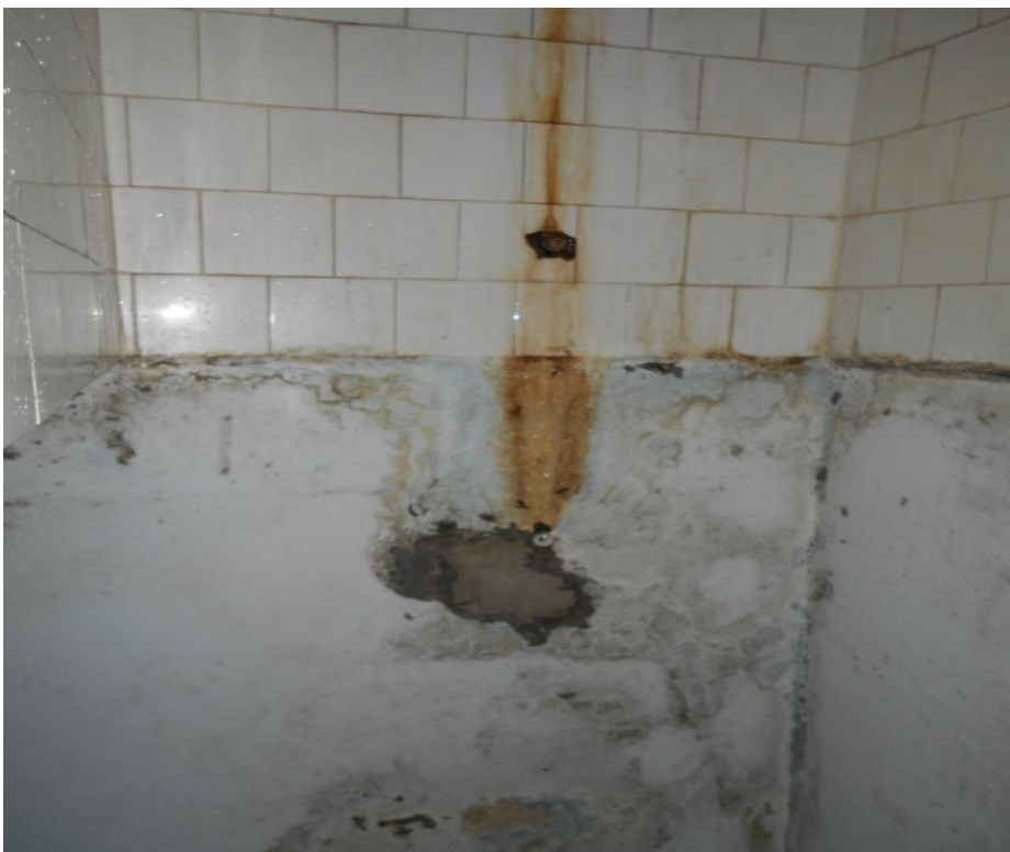
Péssimo estado de conservação de um dos banheiros.
