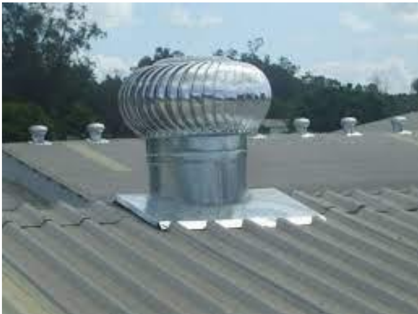
Figura 4: Sistema de exaustão eólica.
